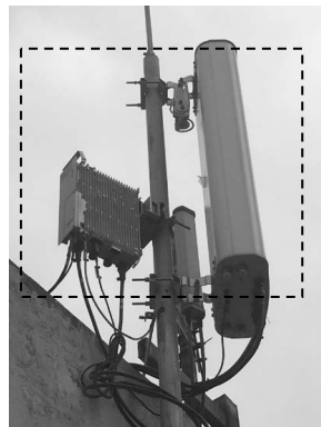
图5 苏州电信的楼顶站
