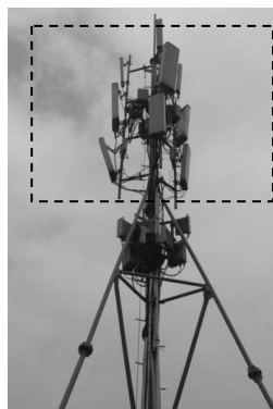
图4 苏州电信的楼顶塔站
